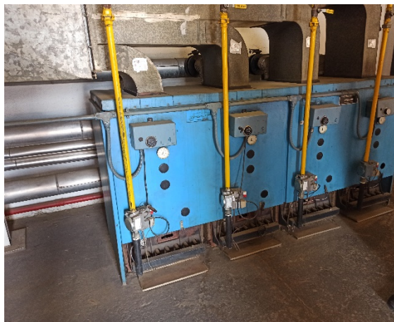
Figura 27. Mòdul de caldera general
