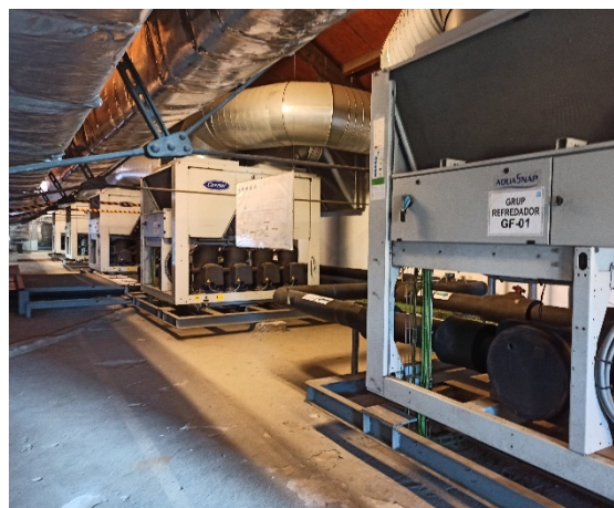
Figura 52. Equips de producció de climatització.
