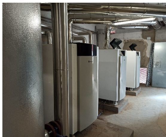
Figura 38. Noves calderes de condensació de Pavelló Nord
