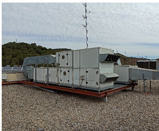
Figura 37. Climatitzador del Bloc C
